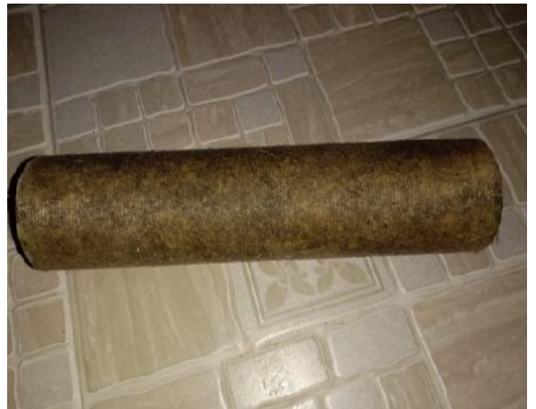
FILTER YANG KOTOR PADA SR
