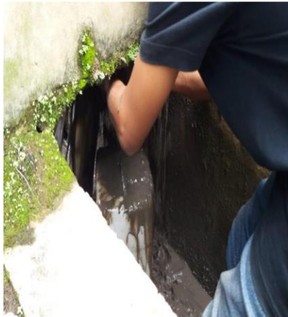
Proses pengambilan lumpur pengolahan Air
